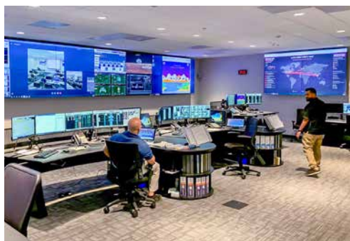
Sala de control
